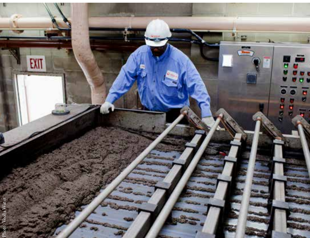
Usine de traitement des eaux usées à Burlingame, Californie, États-Unis.
